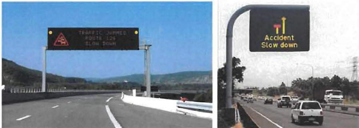
Figura 19 – Exemplu tipic de panou tip VMS de informare rutiera, text + grafic, si modul de instalare pe portal metalic sau pilon cu consola
